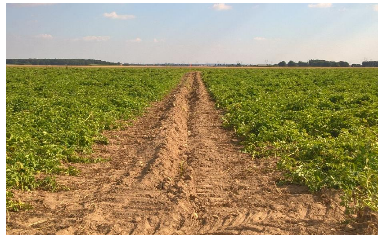
Figure 268 : Tranchée pour le passage de réseau électrique HTA à partir d'un soc tracté
