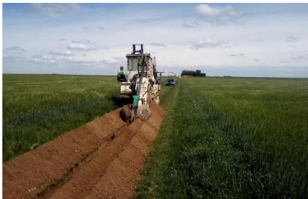
Figure 267 : Tranchée pour le passage de réseau électrique HTA à partir d'une trancheuse
